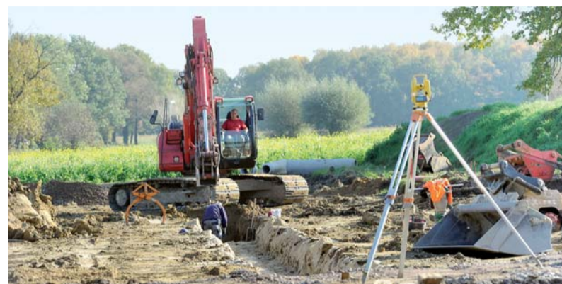
Die erste Bauphase startete Mitte Juli. In 2013 erfolgt die Herstellung der Straßen und Wege.
