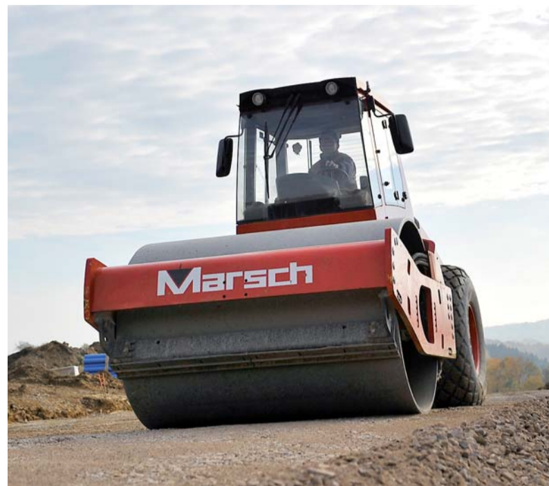
Die von der Gustav Marsch GmbH & Co. KG auszuführenden Arbeiten umfassen die Bereiche Kanalbau, Straßenbau und die Erstellung der Versorgungsleitungen.
