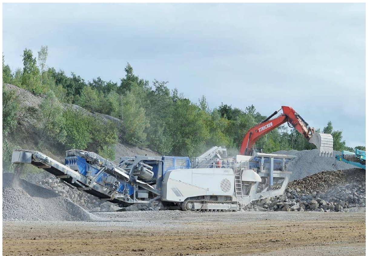
Bei der mobilen Aufbereitung des Kalksteins stellt das Team der Stricker GmbH & Co. KG ein Baustoff-Mineralgemisch 0/45 mm her.
