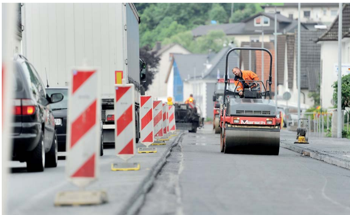
Im August 2010 erhielt die Gustav Marsch GmbH & Co. KG den Auftrag zur Erneuerung der B 229 in Sundern/Hachen im Vollausbau.
