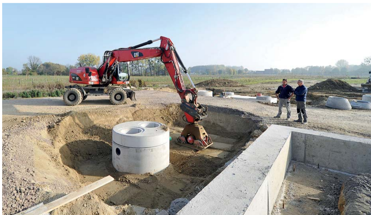
Beim Kanalbau werden ca. 2.500 m Kanal DN 200 bis DN 600 einschließlich der Schachtbauwerke und Abscheideanlagen erstellt.
