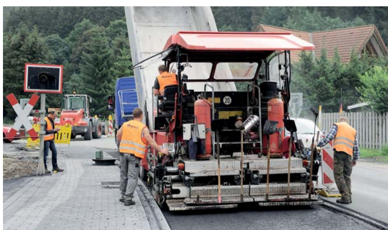
Der Ausbau der 2.215 m langen Strecke erfolgte in Abschnitten von jeweils 100 m unter halbseitiger Sperrung der Fahrbahn.
