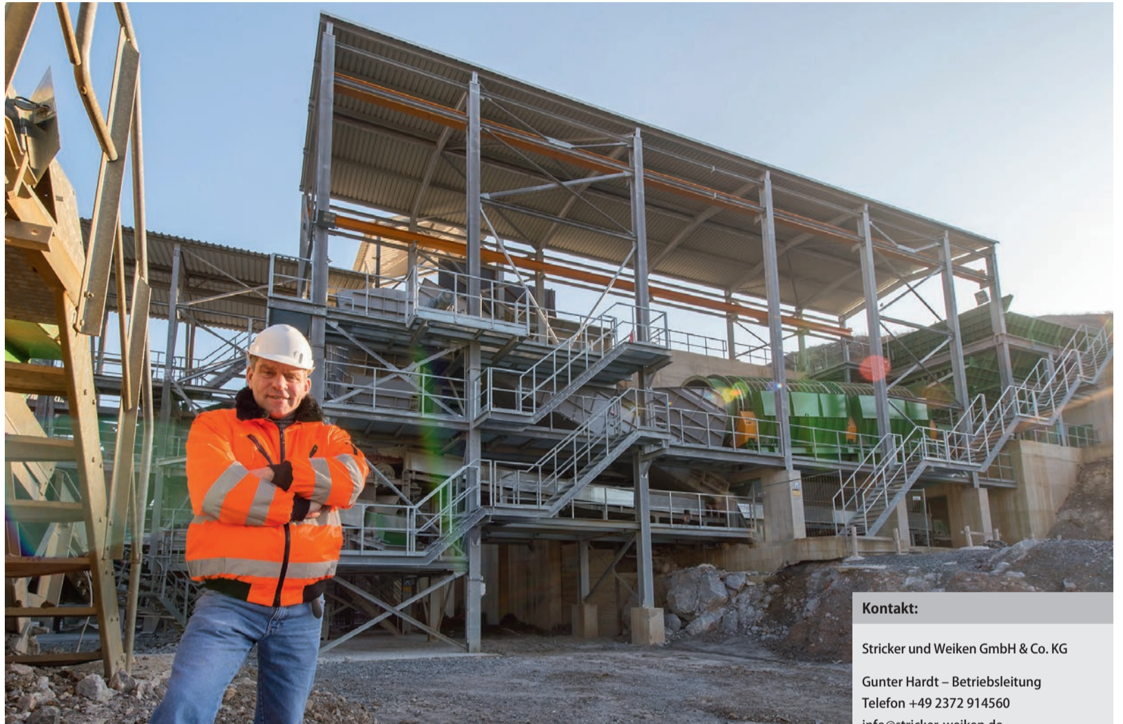
Betriebsleiter Gunter Hardt vor der neuen Anlage
