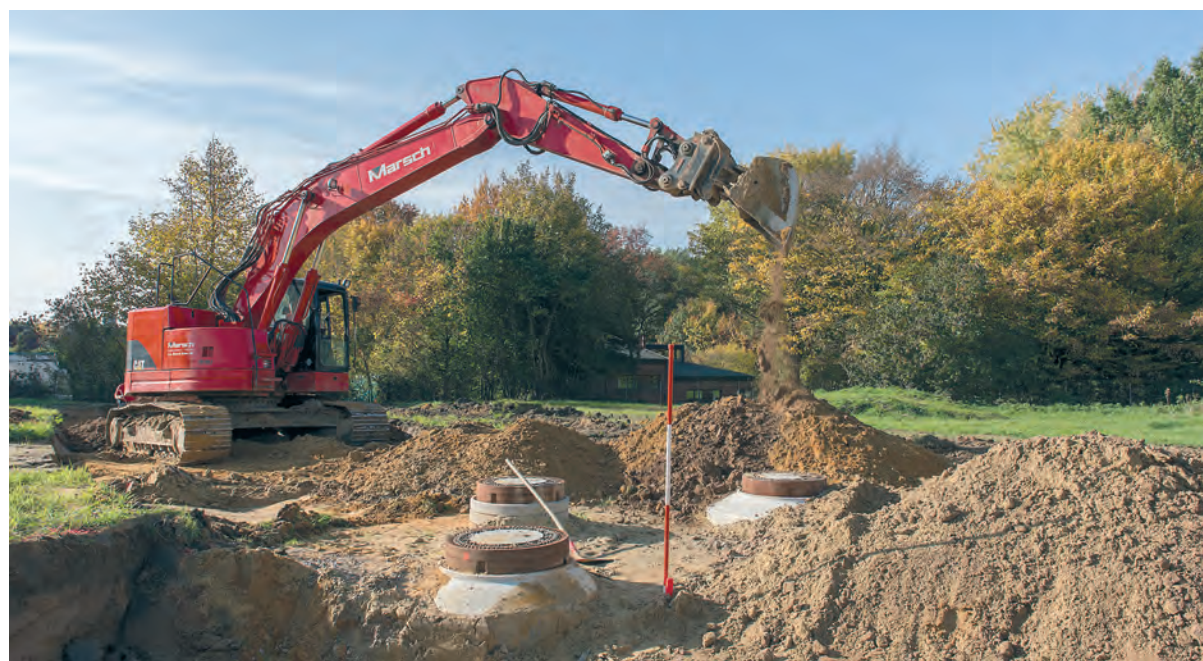
In dem Waldgebiet zwischen den Dortmunder Ortsteilen Rahm, Wischlingen und Huckarde entsteht ein attraktives Neubaugebiet.
